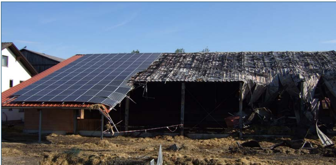
Abb. 1: Typischer Brandschaden einer Photovoltaikanlage 1
